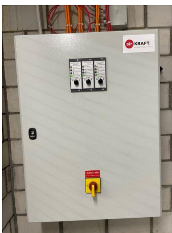
Schaltschrank mit Bedienpanel
