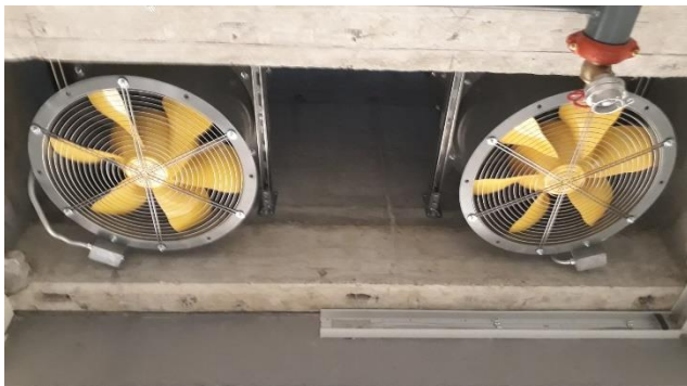
Ventilatoren im Rohbau Gebäude
