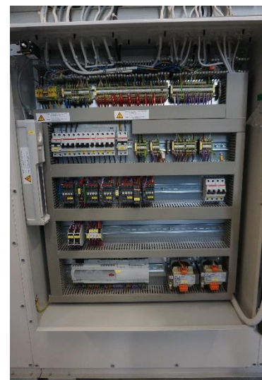
mit integrierter Regelung
