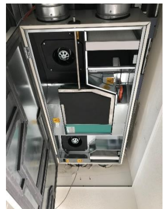
Lüftung soz. Räume
