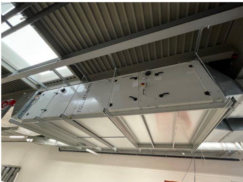
Lüftung Laden, platzsparend über der Kühlzelle platziert
