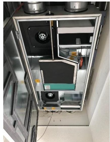
Lüftung soz. Räume
