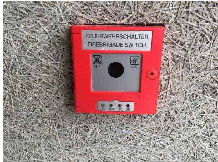
Feuerwehr Schalter - Betriebszustand
