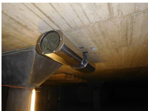
Jet Fan montiert
