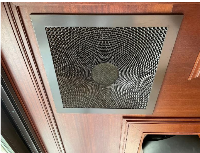
In abgehängter Decke mit Verkleidung
